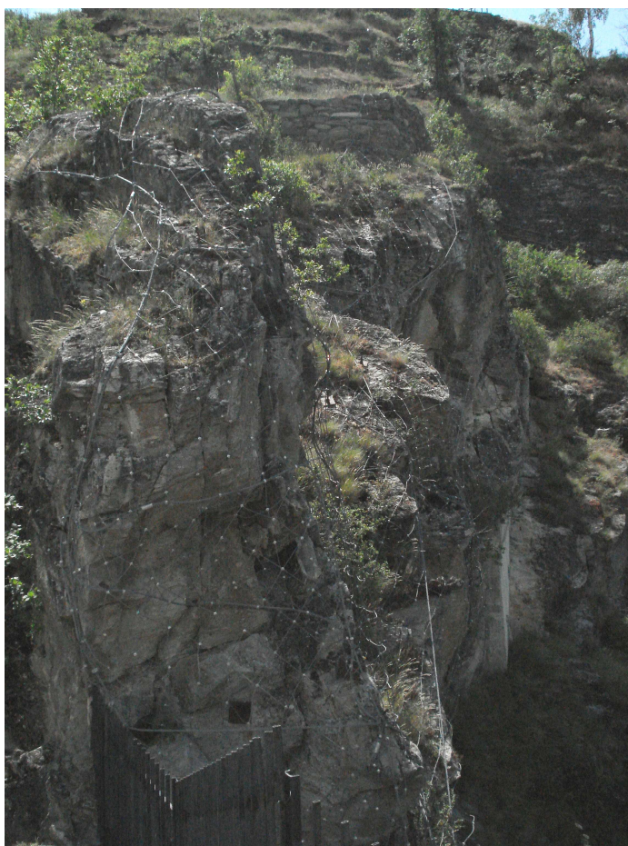
Foto 8.3 Particolare delle opere di protezioni attive a difesa del capoluogo di Villeneuve
